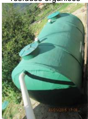
Figura 36 - Biodigestor instalado em um restaurante de grande porte para tratamento de resíduos orgânicos
