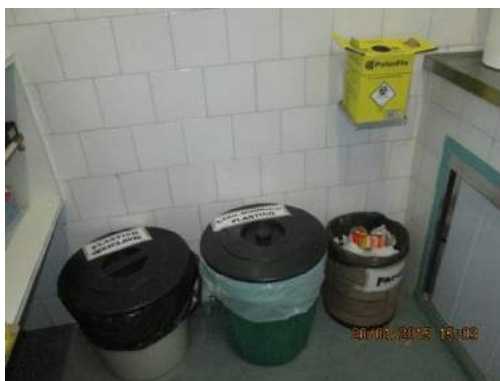
Figura 65 - Acondicionamento de resíduos comuns na Santa Casa de São Bento do Sapucaí
